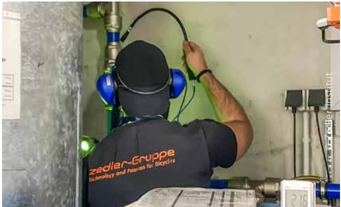
Mitarbeitender bei der Prüfung eventueller Leckagen im Druckluftnetz
