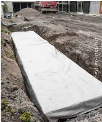
Rigolen zur langsamen Versickerung des Regenwassers
